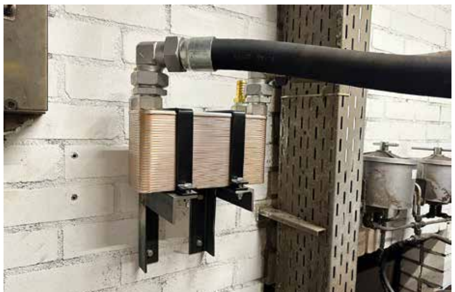
Via een platenwarmtewisselaar (hier nog niet aangesloten) en een buffervat ‘verwarmt’ de HPU eigenlijk de nieuwe productiehal.
